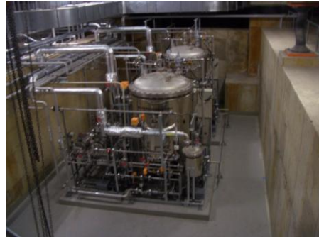
(改修後) 感染排水処理設備（省エネ型）
