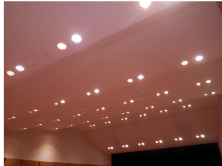
(改修後) LED照明
