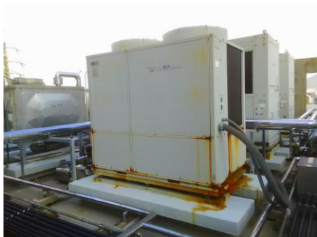
(改修前) 冷温水チラー
