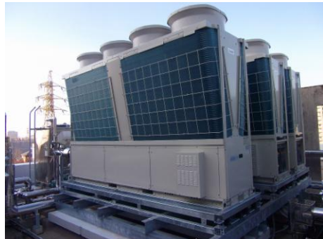
(改修後) 冷温水チラー（高効率型）
