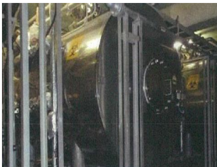
(改修前) 感染排水処理設備
